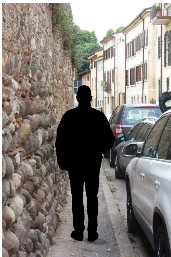
Figura 17 Larghezza utile del marciapiede all'altezza del massimo spanciamiento del muro di cinta
