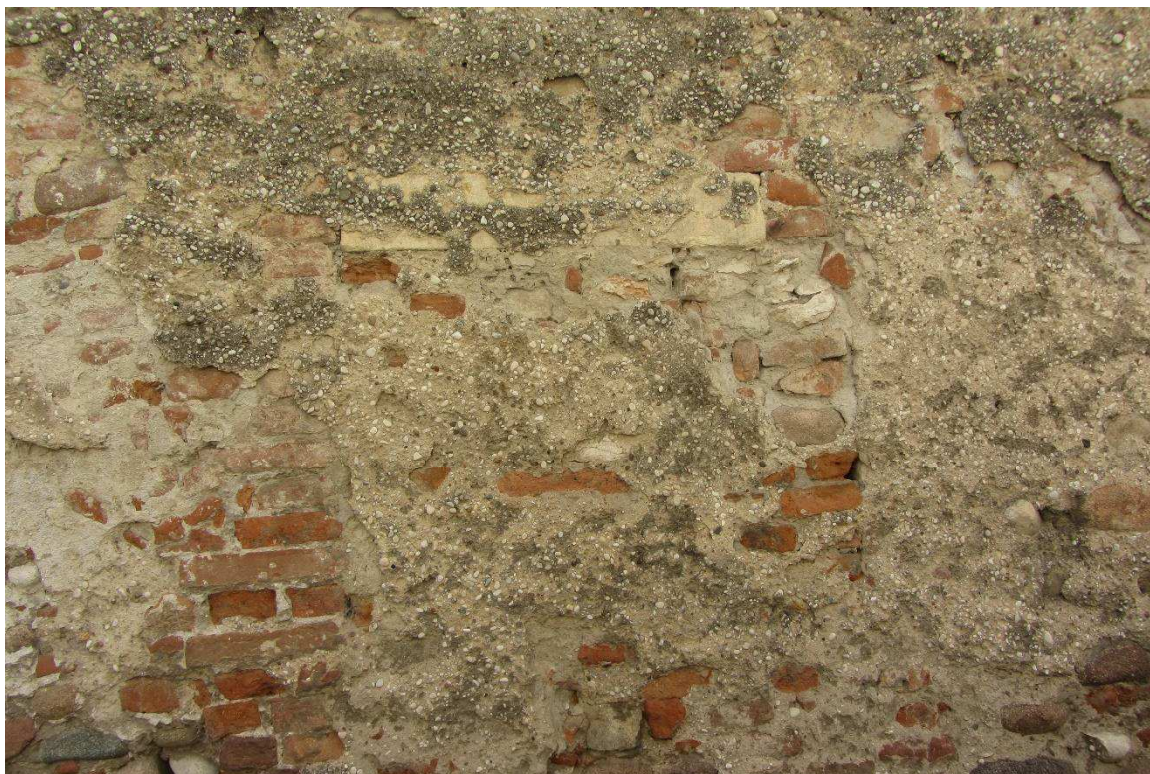
Figura 1 Residui dell'intonaco di rivestimento, ancora visibili sulla superficie del muro
